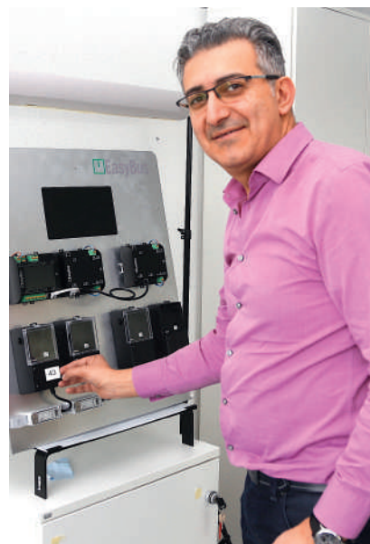
L'adressage des modules se fait à l'aide d'une étiquette autocollante RFID. Samer Abdo, directeur R&D et industrialisation chez SDataway, démontre la simplicité de l'opération.
